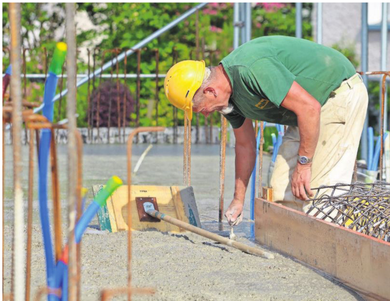
Ein Arbeiter der Willisauer Bauunternehmung Stutz AG beim Betonieren im «Stärnematt»-Quartier. Foto Chantal Bossard
